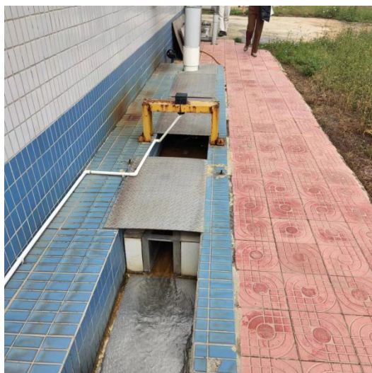
图1 废水处理设施规范化排污口
