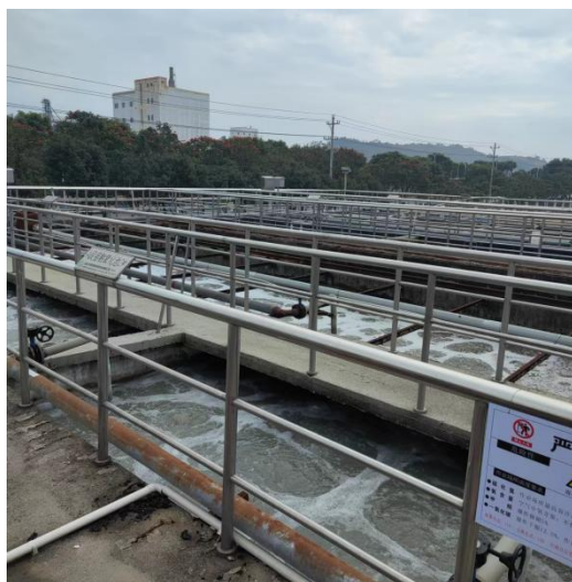
图2 废水处理设施
